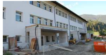
Die Sillianer Volksschule und die Polytechnische Lehranstalt erhalten künftig einen eigenen Eingang in das Gebäude. Foto: Micheler
